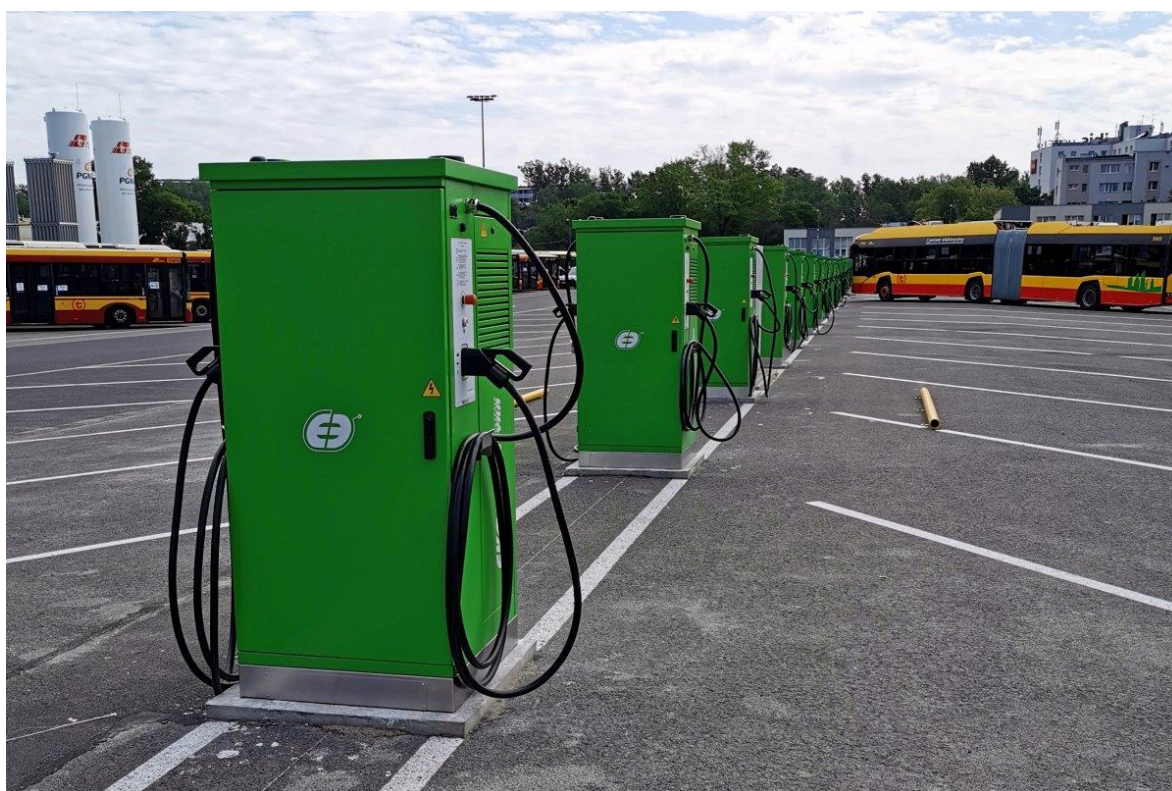
Zdjęcie 1. Ładowarki plug-in zainstalowane na zajezdni w Warszawie
